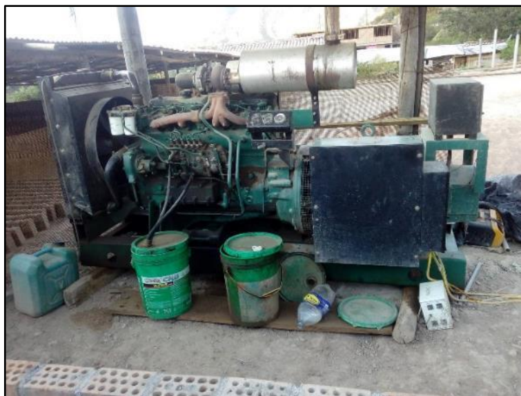
Figura V-6: Generador usado en la fabricación de ladrillos
