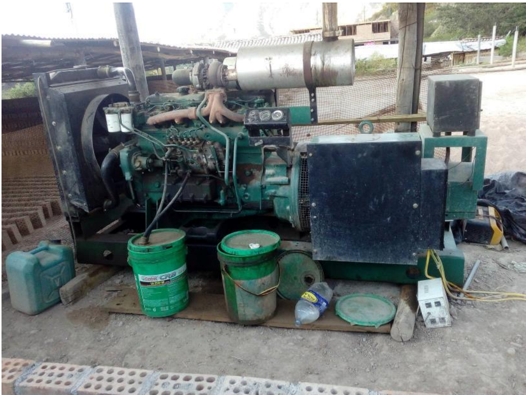
Generador eléctrico de la fábrica de ladrillos granados
