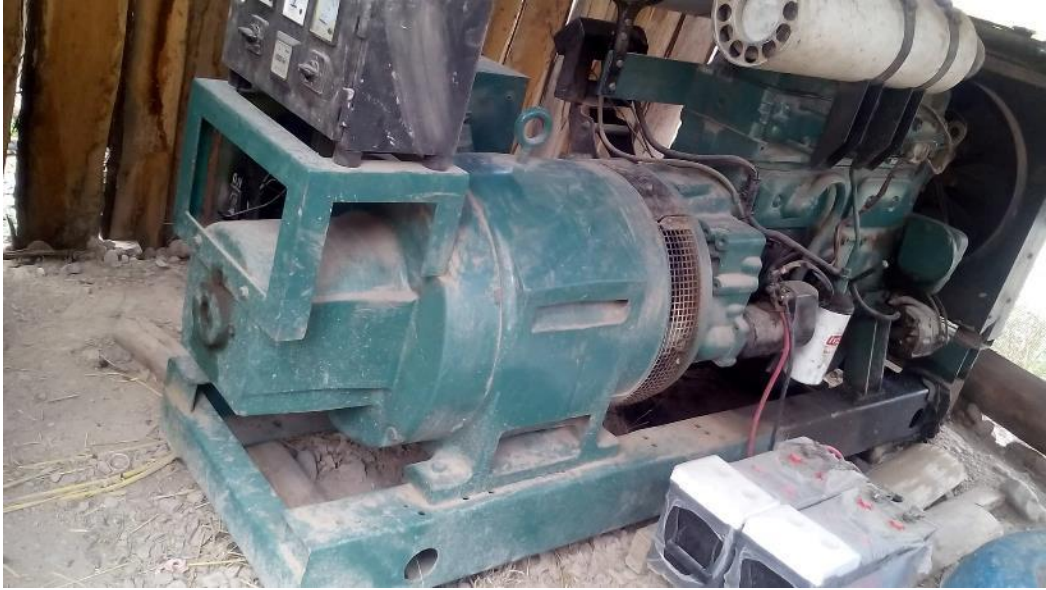
Generador eléctrico de la fábrica de ladrillos granados
