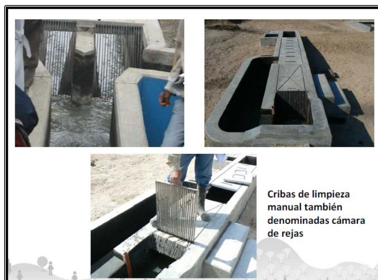
Figura N° 2.17: Rejilla fija con limpieza manual
