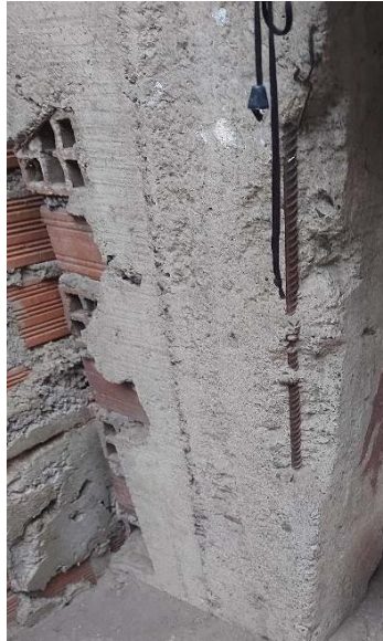
Ilustración 24. Vivienda 2-columna expuesto el fierro y completado la dimensión con ladrillo Fuente: Propia
