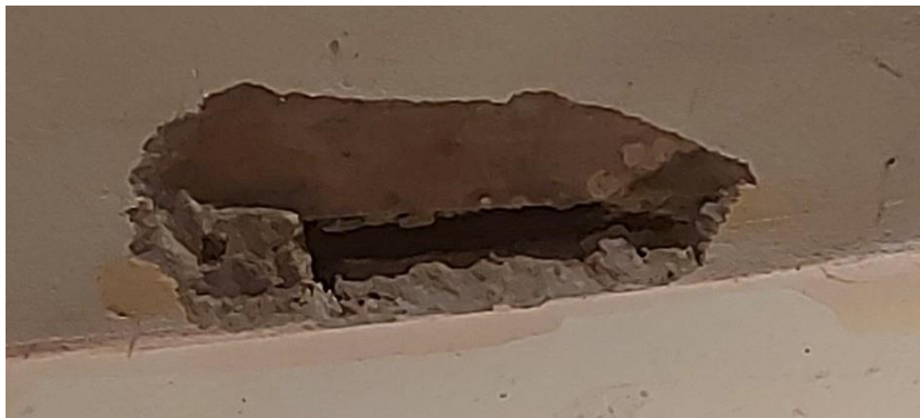
Ilustración 31. Vivienda 3- Desprendimiento de concreto en el techo. Fuente: Propia
