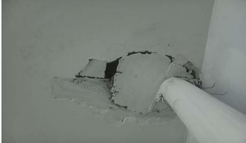
Ilustración 17. Casa 1- rajadura en muro Fuente: Propio
