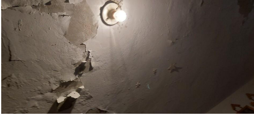
Ilustración 32. Vivienda 3-Eflorescencia en cielo raso. Fuente: Propia
