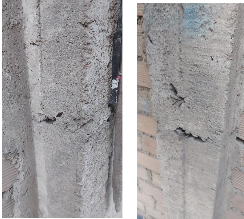
Ilustración 26. Vivienda 2- Segregaciones en columnas Fuente: Propio
