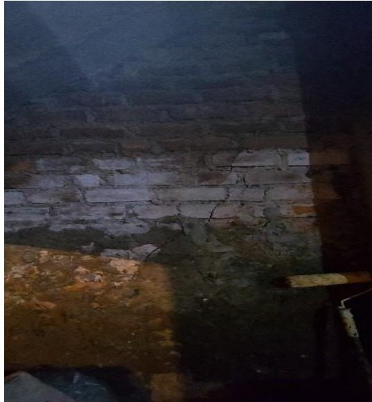
Ilustración 20. Vivienda 1-rajadura y eflorescencia en muro. Fuente: Propia
