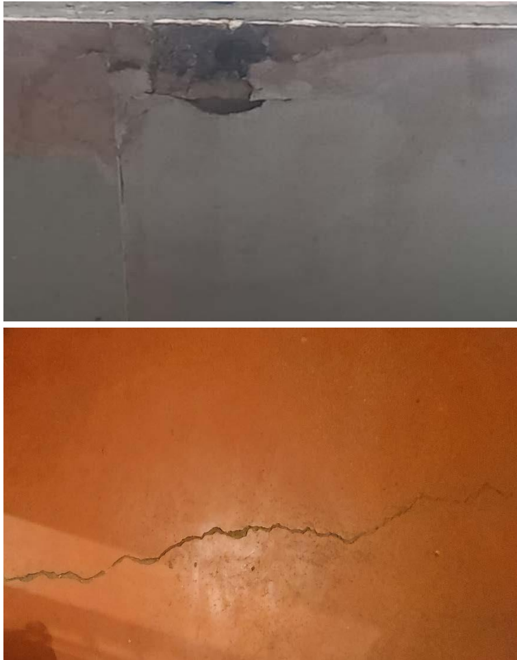
Ilustración 19. Vivienda 1- rajaduras en piso del primer nivel Fuente: Propia
