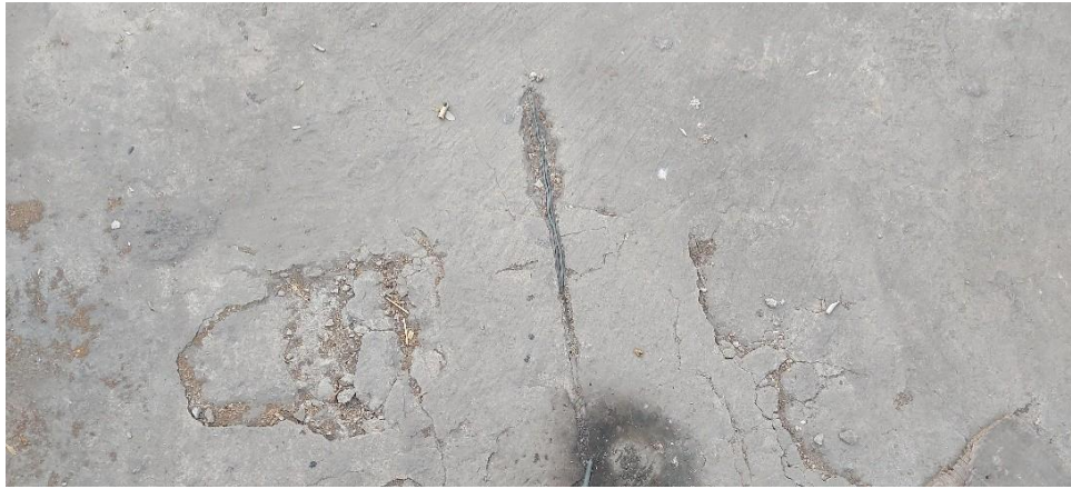
Ilustración 28. desprendimiento de concreto en losa y exposición de la armadura. Fuente: Propia
