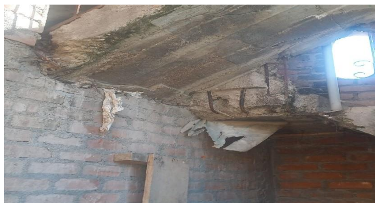
Ilustración 21. Casa 1- armadura de hierro corrugado expuesto Fuente: Propia
