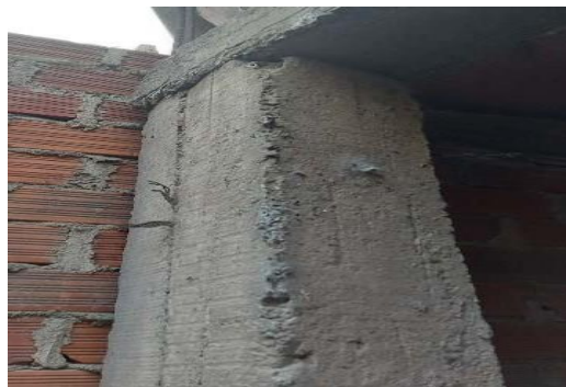
Ilustración 25. Vivienda 2-Junta fría Fuente: Propia
