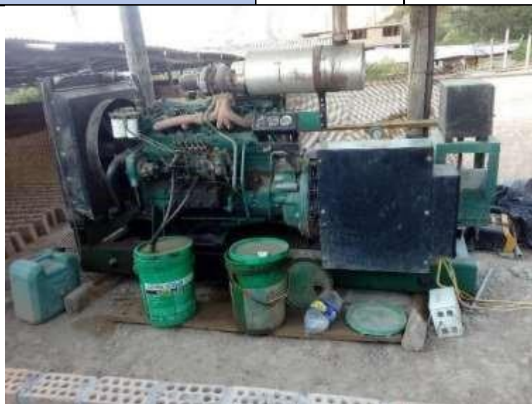
Figura V-6: Generador usado en la fabricación de ladrillos
