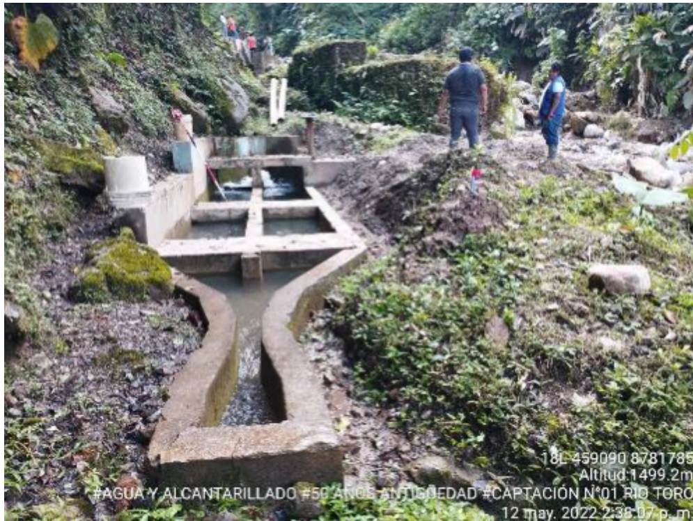
Fotografía 5 Se observa obras civiles en estado grave.
