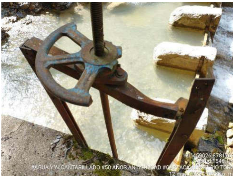
Fotografía 4 Se observa captación en estado de colapso Fecha: Nov-21
