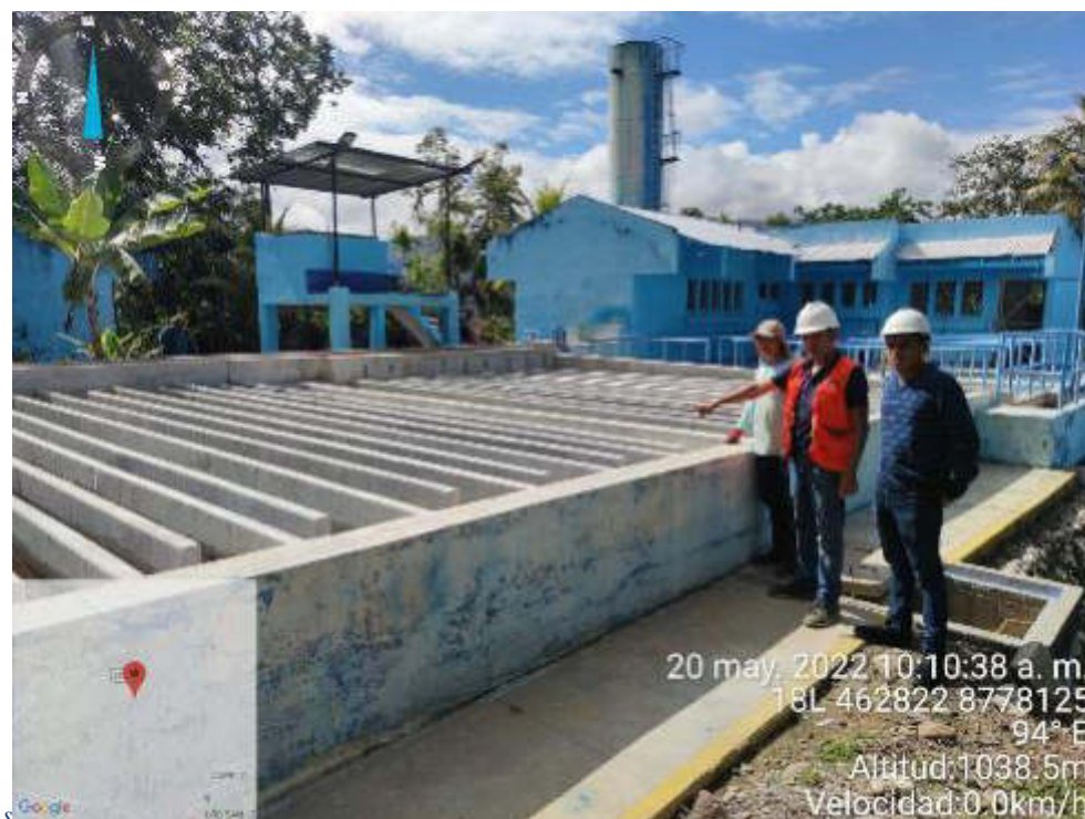
Fotografía 12 Se observa el estado situacional de la planta de tratamiento de agua potable
