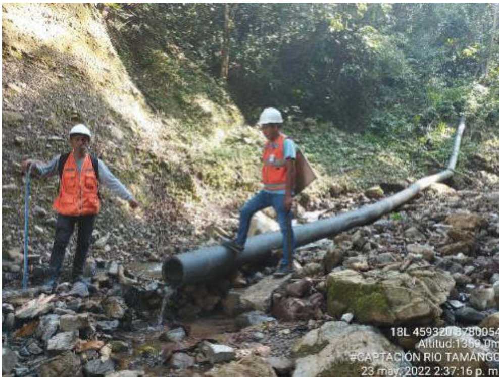
Fotografía 6 Se observa el estado situacional de sistema de conducción de agua potable.
