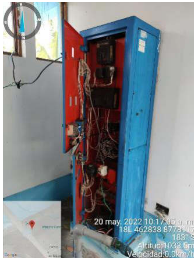
Fotografía 13 Se observa sistema eléctrico de la planta de bombeo, en estado de colapso.
