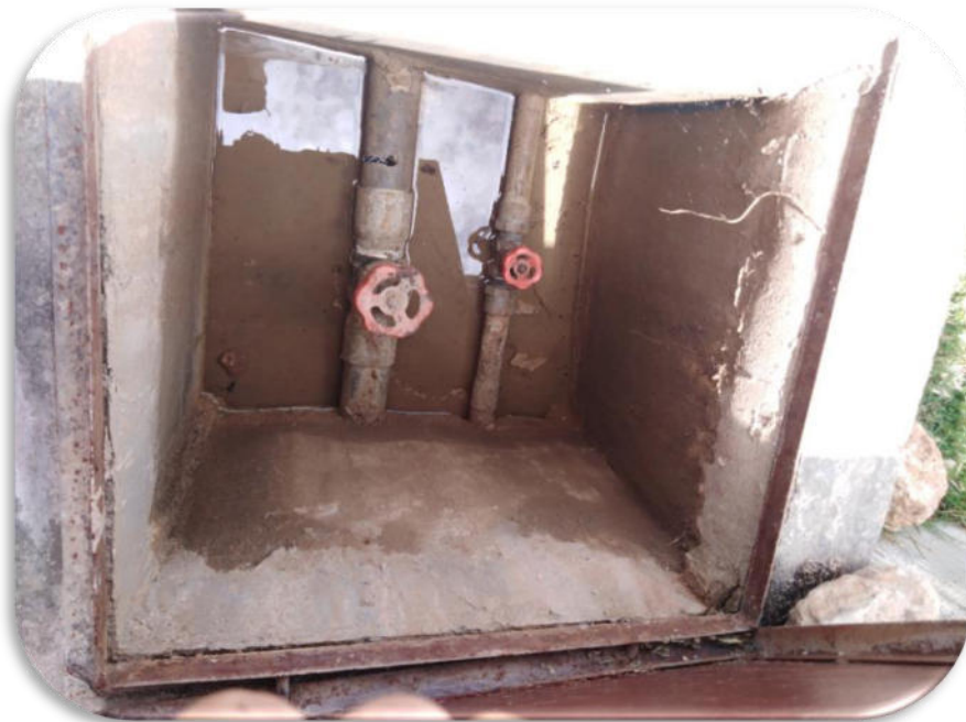
FOTO 14: Evaluación de la caja de válvulas
