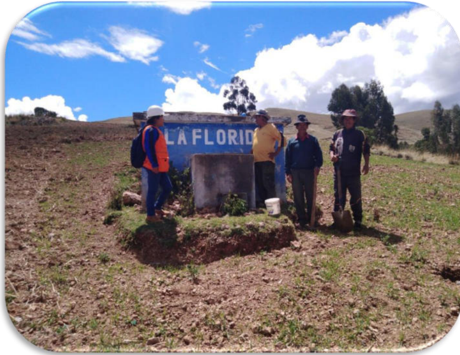
FOTO 13: Vista panorámica del reservorio 1 del sistema 3
