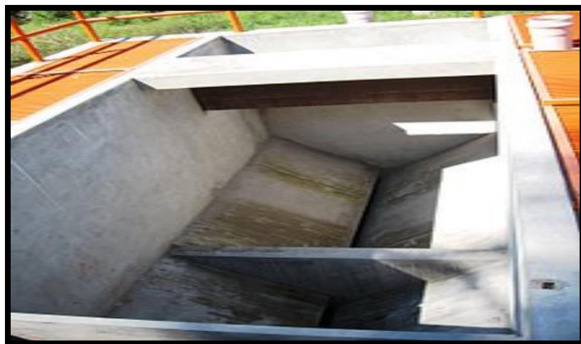
Foto: 2.4 Tanque Imhoff
