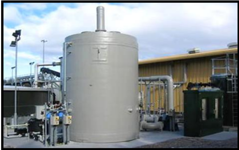
Foto: 2.7 Reactor UASB
