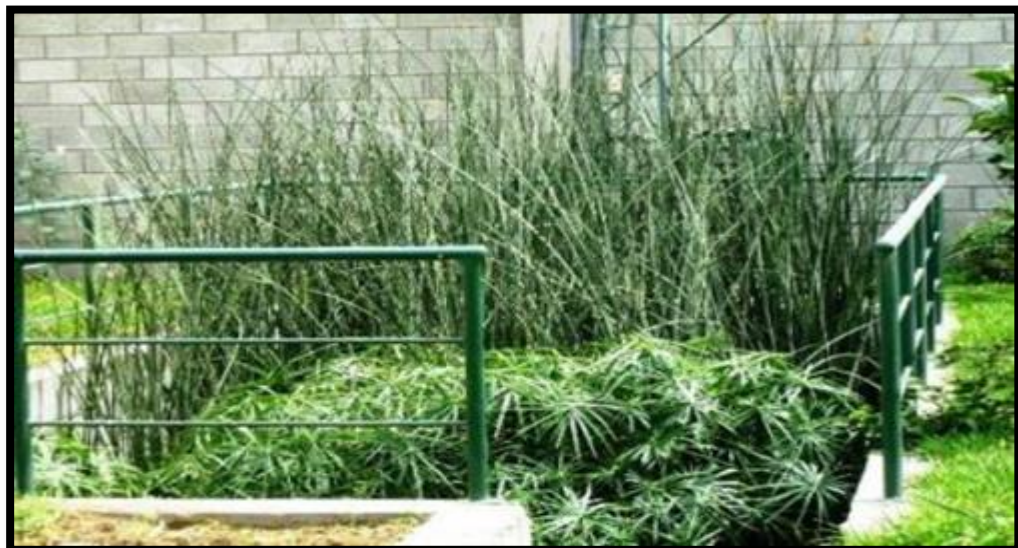
Figura: 2.11 Humedal flujo horizontal con gravilla en un colegio en Trujillo
