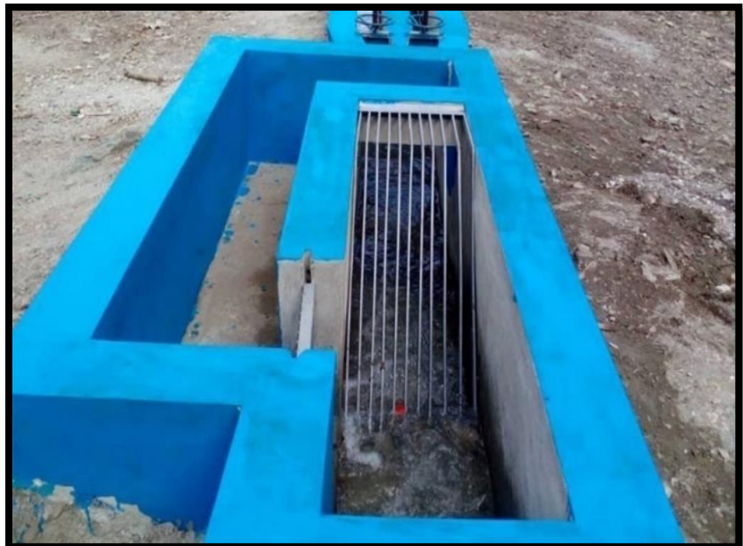
Foto: 2.1 Cámara de Rejas Fuente: Municipalidad Provincial de Huari
