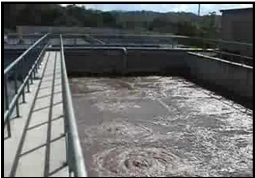
Foto: 2.8 Lodos Activados
