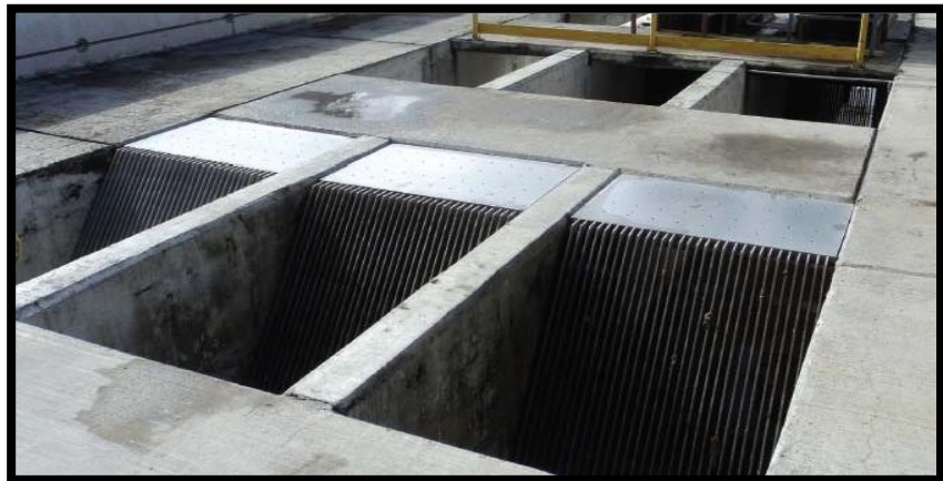
Figura: 2.4 Cámara de Rejas
