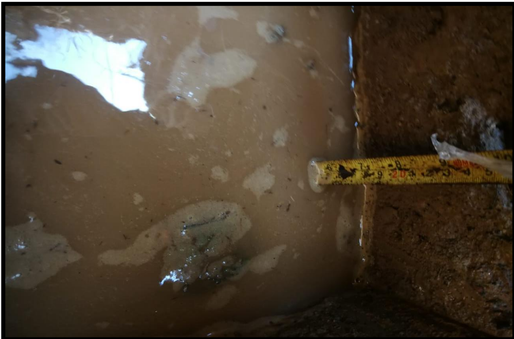
FOTOGRAFIA N° 26- Tés de Percolación en la Ubicación de La Planta de Tratamiento de Aguas Residuales
