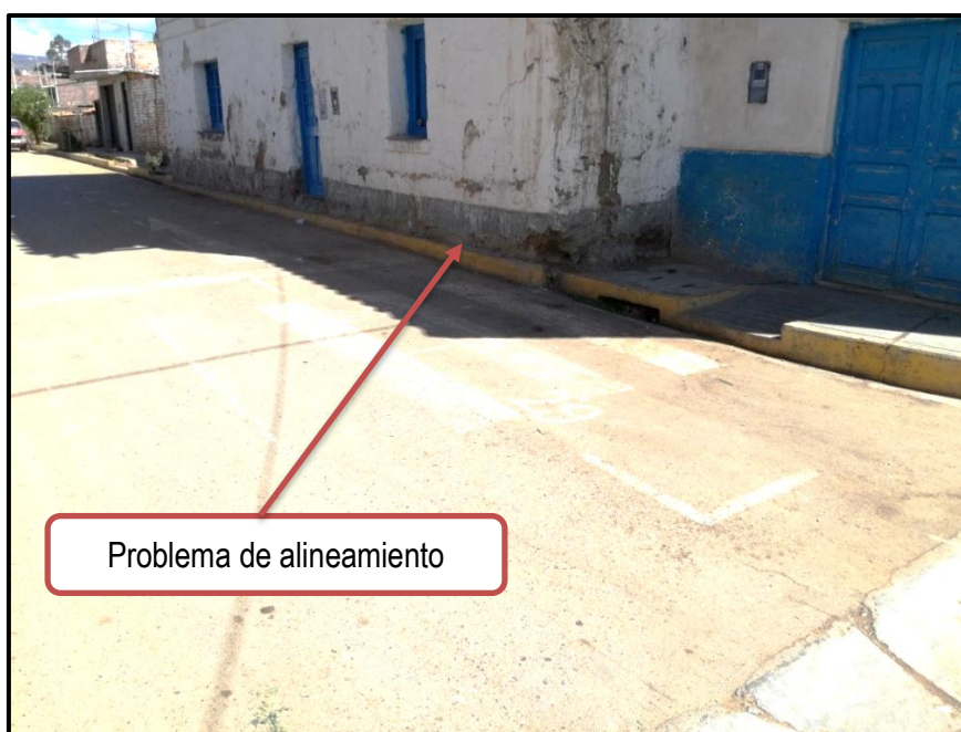
Figura 11: Alcantarilla y vivienda no alineada
