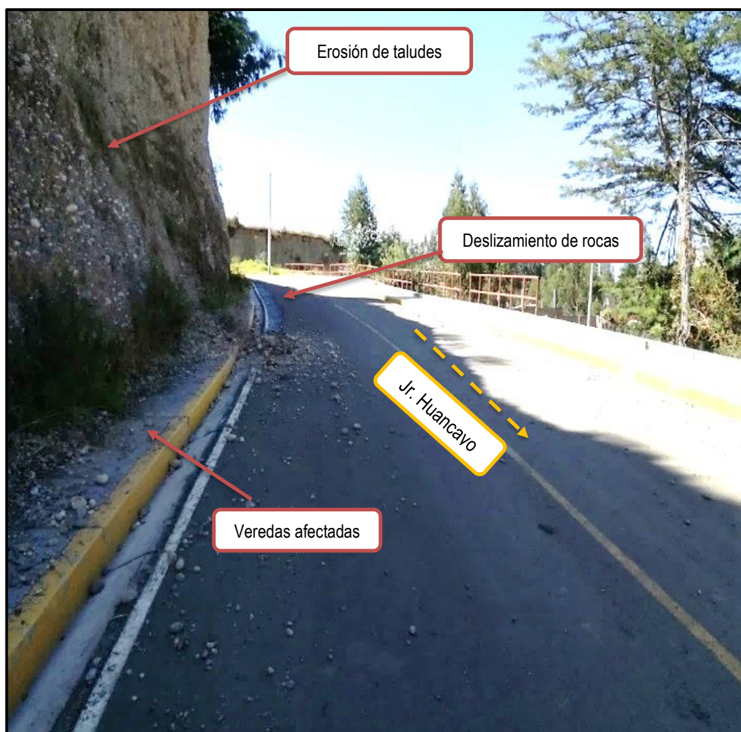
Figura 10: Erosión de taludes
