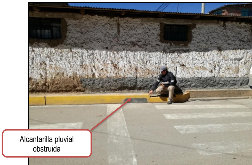
Figura 13: Alcantarilla pluvial obstruida
