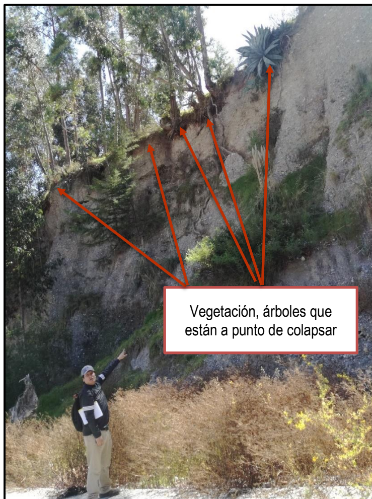
Figura 17: Vegetación por colapsar
