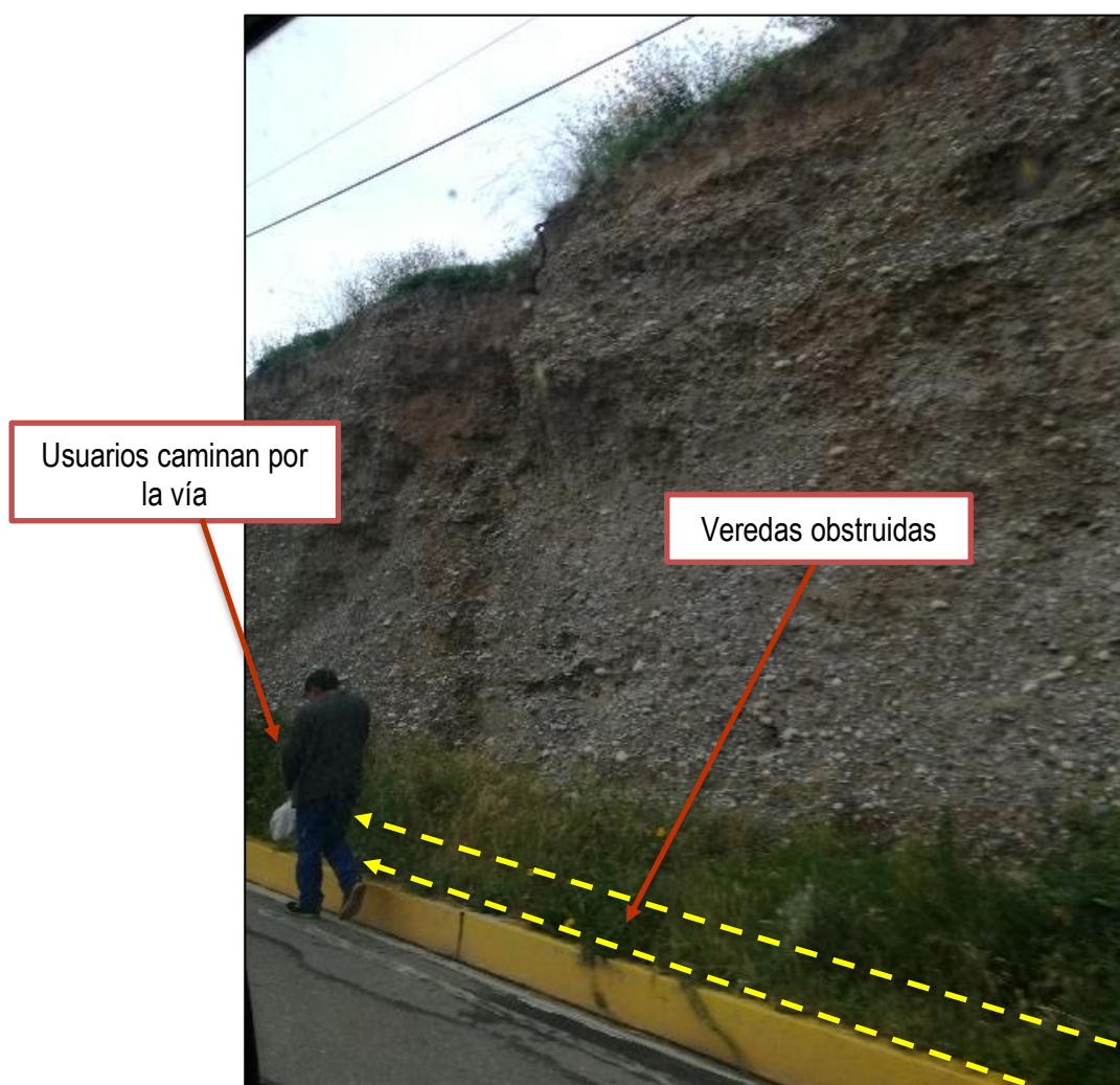
Figura 16: Veredas Obstruidas en el Jirón Huancayo
