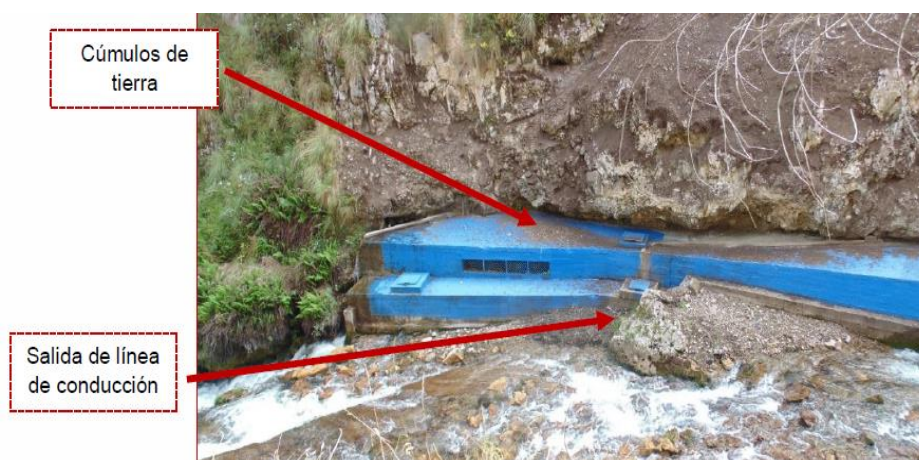
Figura 32: Captación “Chiapuquio” – Sistema de AP
