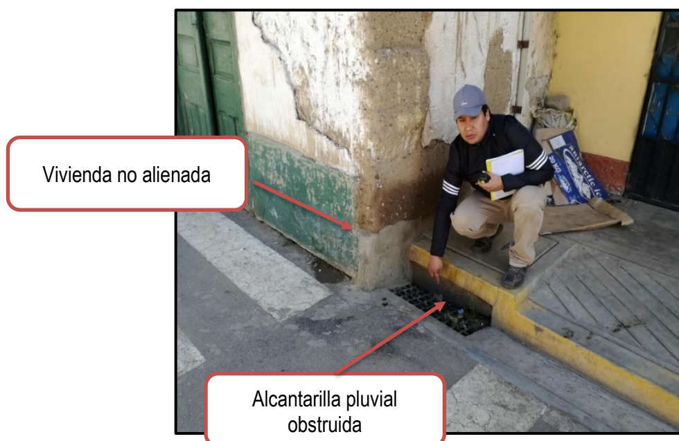
Figura 12: Alcantarilla bloqueadas y viviendas no alineadas
