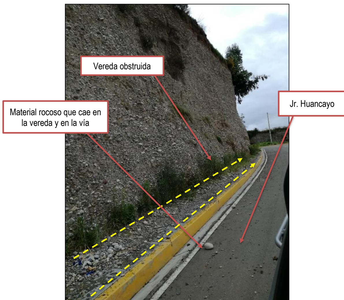
Figura 15: Conjunto de problema en el Jr. Huancayo.
