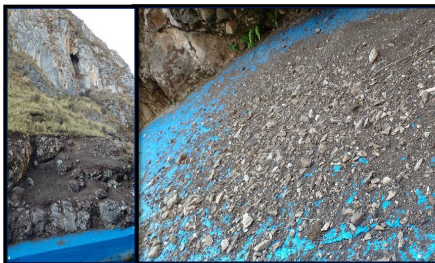
Figura 29: Erosión del suelo en la parte superior de la captación
