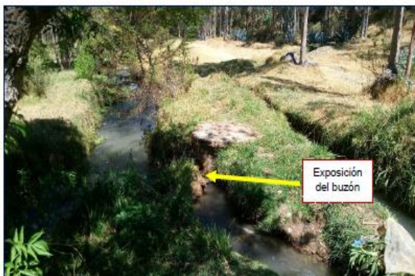
Figura 41: Condiciones inadecuadas de la infraestructura de alcantarillado
