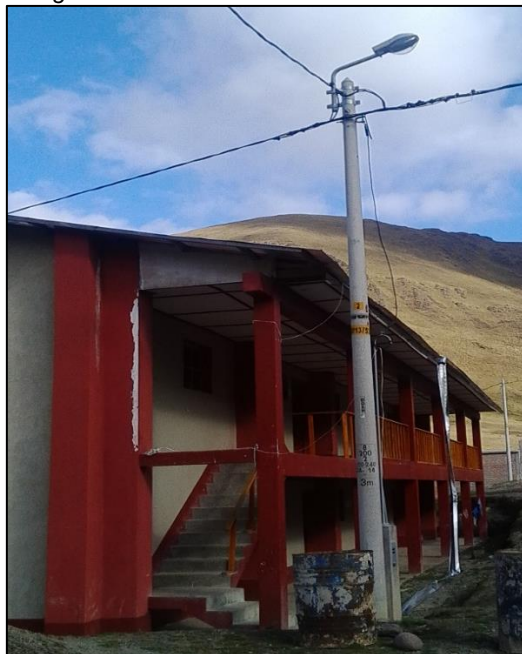
Fotografía 6: Instalaciones eléctricas en Rodeo
