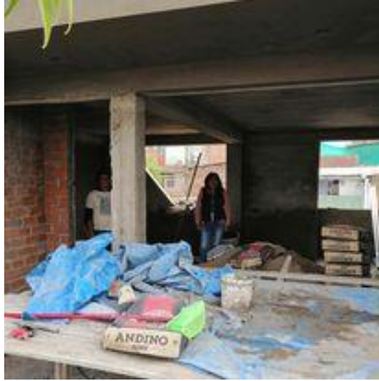
Fotografía 4: Construcción N°2 -Falta de orden y limpieza
