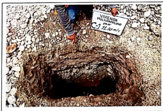
FOTO 04.- C-1, DISEÑO ESTRUCTURAL DE UN EDIFICIO DE VIVIENDA MULTIFAMILIAR DE CONCRETO ARMADO DE 15 PISOS Y TRES SOTANOS, AV. MARIATEGUI Nº 320
