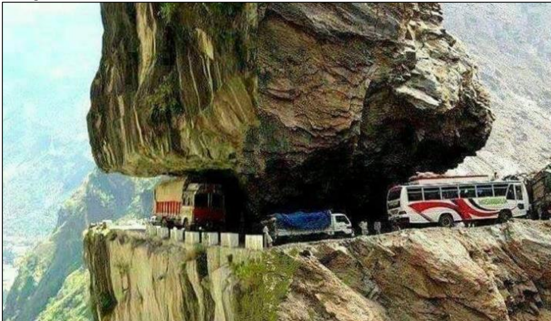
Fotografía 3: Diseño inadecuado, fuera de los lineamientos normativos
