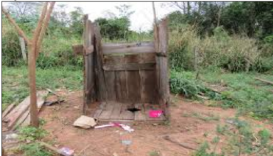
Fotografía 3: Letrinas en estado crítico, a falta de instalación de unidades básicas de saneamiento.
