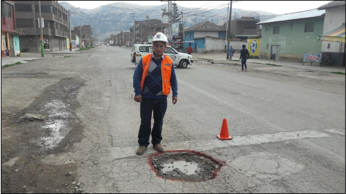
Inspeccion de fallas asociadas (Huecos, piel de cocodrilo y parcheo)
