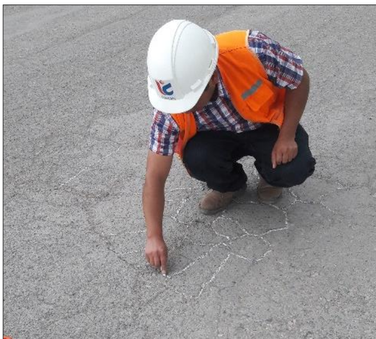
Fotografía N° 7: Identificación de tipo de falla
