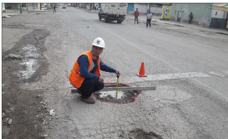
Fotografía N° 6: Inspección de detalles de daño Hueco
