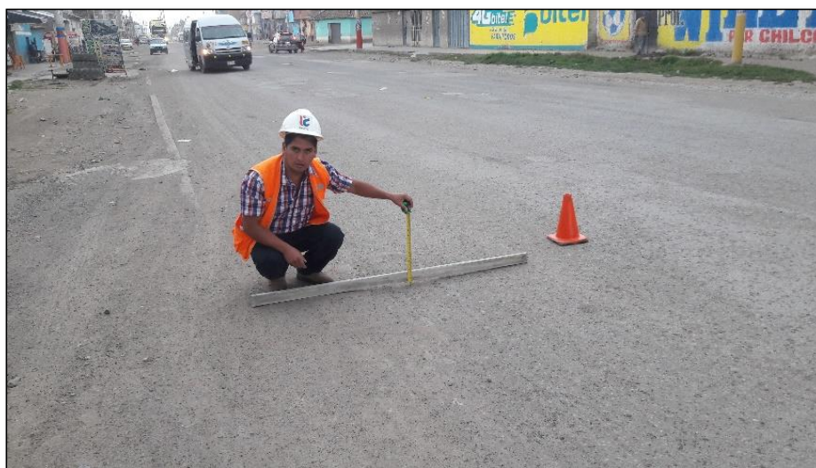
Fotografía N° 3: Observación Directa de Patologías del Pavimento
