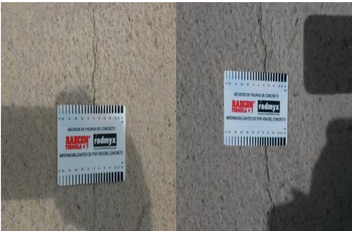
FOTO 3. Fisura de e=1.2\text{mm} de 7.60 m de Long. Transversal y Fisura e=1.4\text{mm} de 7.60 mm de Long. Fuente propia
