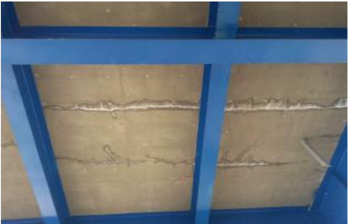
FOTO 5 Fisura Transversal Pasante, una Continua y otra Discontinua. Fuente propia.
