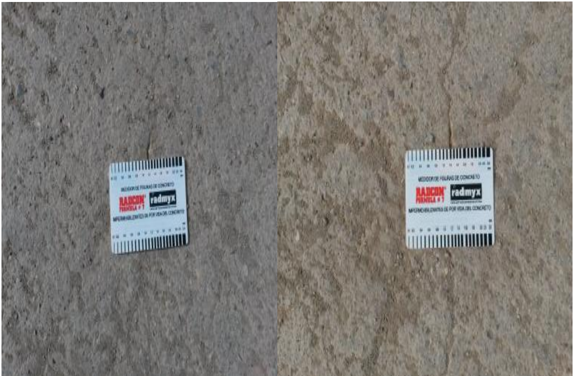
FOTO 2 Fisura e=1.2\text{mm} , 10m Long. Fisura Transversal Y Fisura e=1.2\text{ mm} , 4.2m Log. Fuente propia
