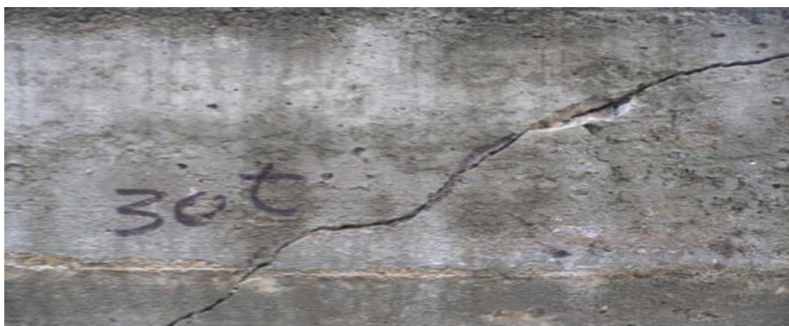
FIGURA 40 Viga de Control agrieta Generada por Corte a 30 Tn. Fuente Cárdenas Rincón.
