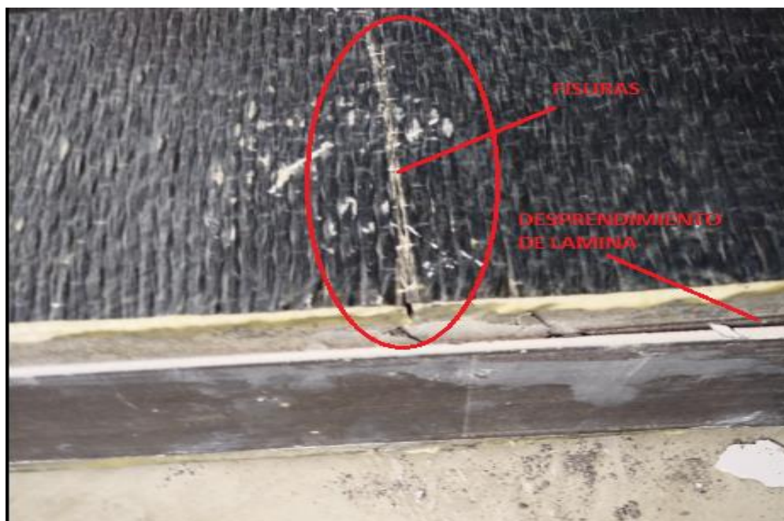
FOTO 21 Se Observa la Fisura en la Manta de Carbono y el Desprendimiento del Carbono. Fuente propia.
