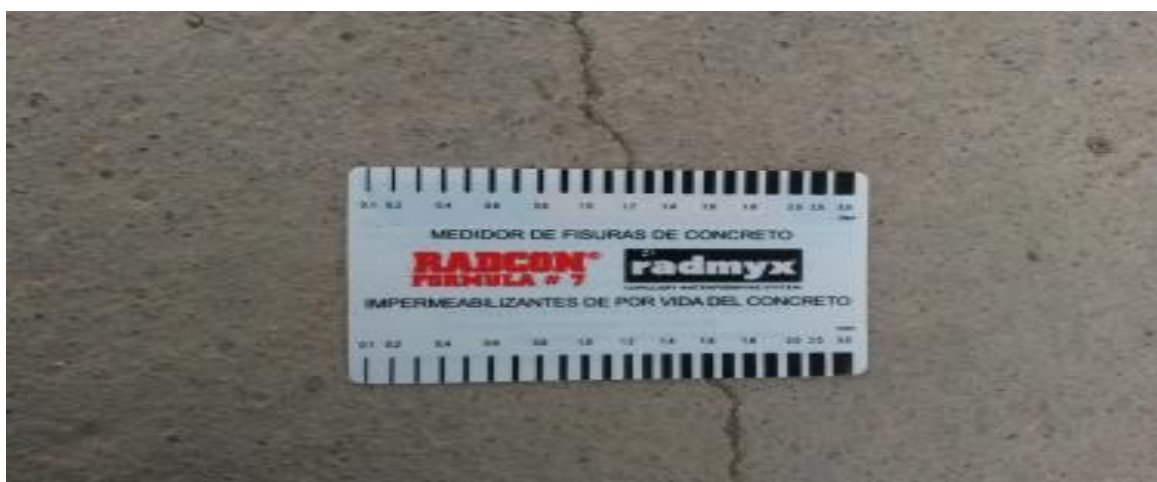
FOTO 1 Fisura Transversal e = 1.2\text{mm} de 7.60m de Long. Fuente propia.
