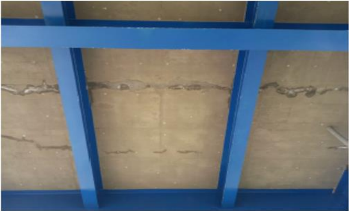
FOTO 4 Fisura Transversal Pasante Continuo. Fuente propia.
